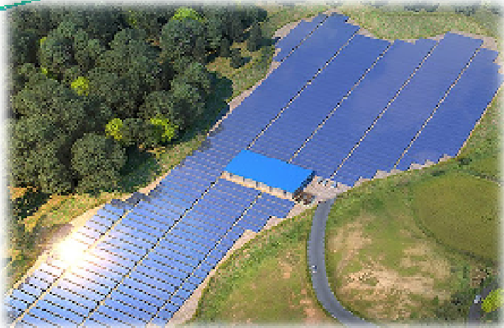
Yeongam Solar Power Plant 93MW – Korea (Nhà máy điện mặt trời Yeongam 93MW – Hàn Quốc)
