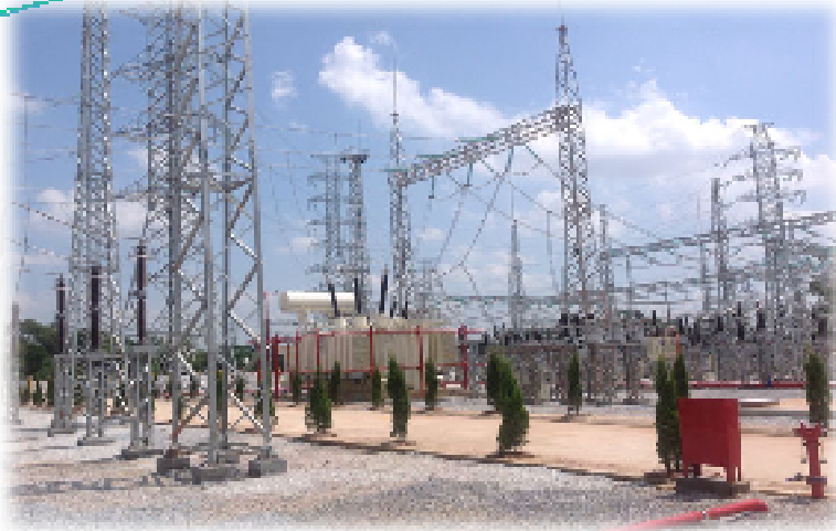
220kV Phu Binh s/s – Thai Nguyen (Trạm 220kV Phú Bình – Thái Nguyên)
