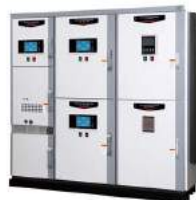
MCSG (Metal Clad)
