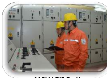
110kV GIS Bo Ho Hoan Kiem, Hanoi (2003)
