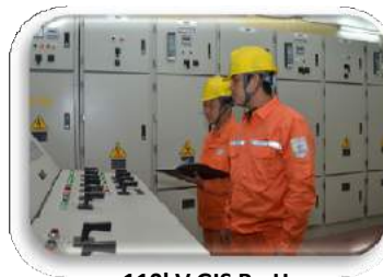
110kV GIS Bo Ho Hoan Kiem, Hanoi (2003)
