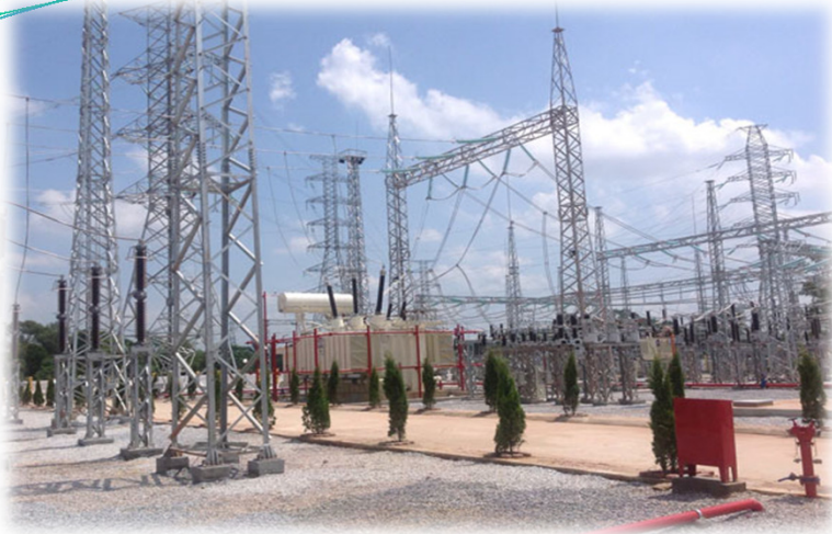
220kV Phu Binh s/s – Thai Nguyen (Trạm 220kV Phú Bình – Thái Nguyên)
