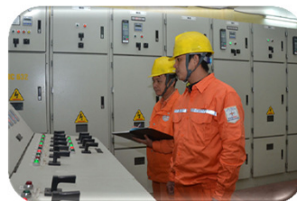
110kV GIS Bo Ho Hoan Kiem, Hanoi (2003)
